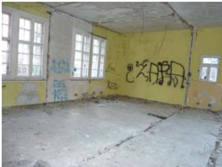
Strop nad piętrem i parterem do rozbiórki
